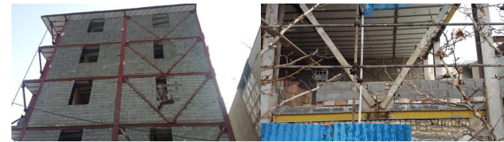
تصویر (۱) ساختمان موجود در حال ساخت عدم طراحی
